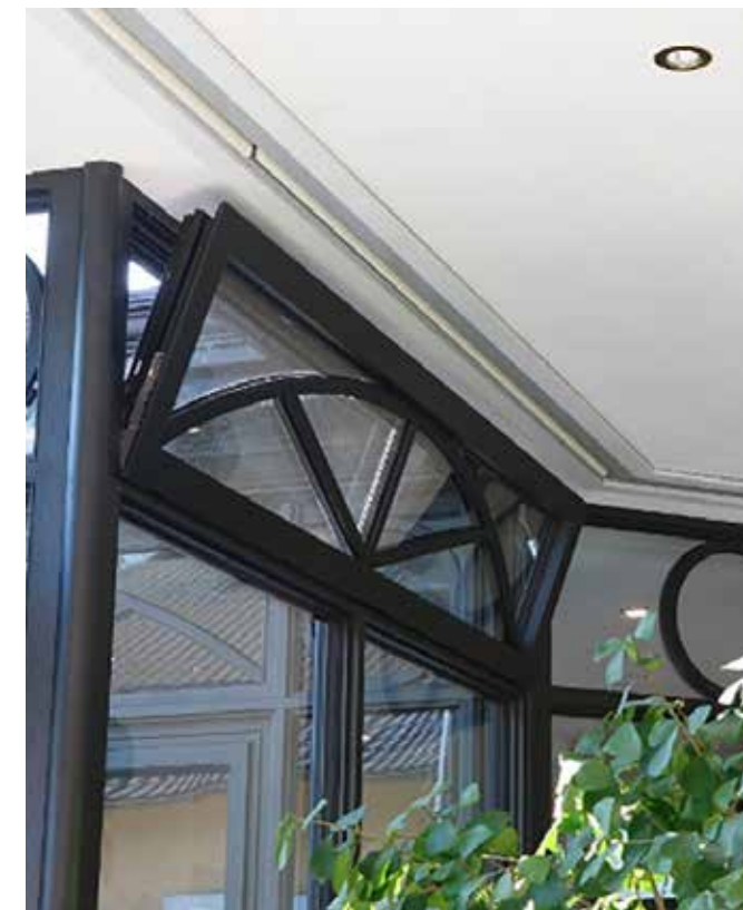
Goed ventileren bij condensvorming aan de binnenzijde
